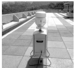
Une partie de l'équipement de mesure installé sur le toit.
